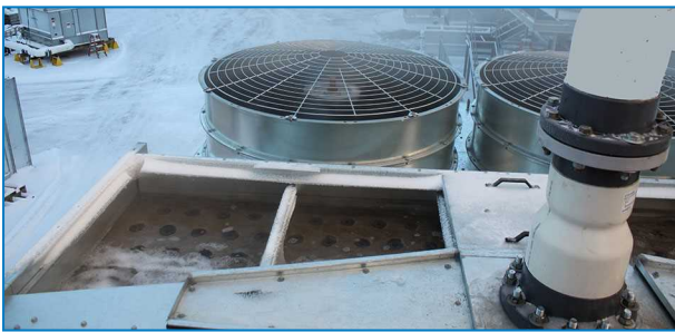
Heißwasserbecken und optionale Abdeckungen Wasserverteilwanne
