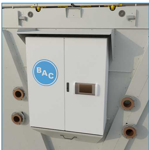
Quadro di comando
