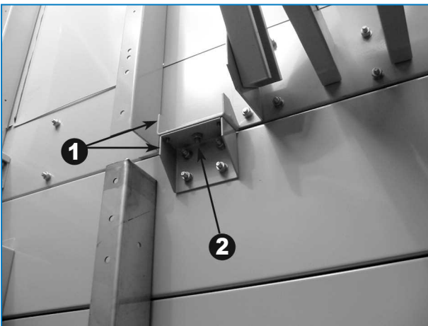
Section plenum installée sur la section inférieure
