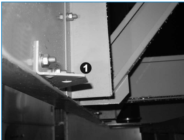
Vue intérieure de la section plenum
