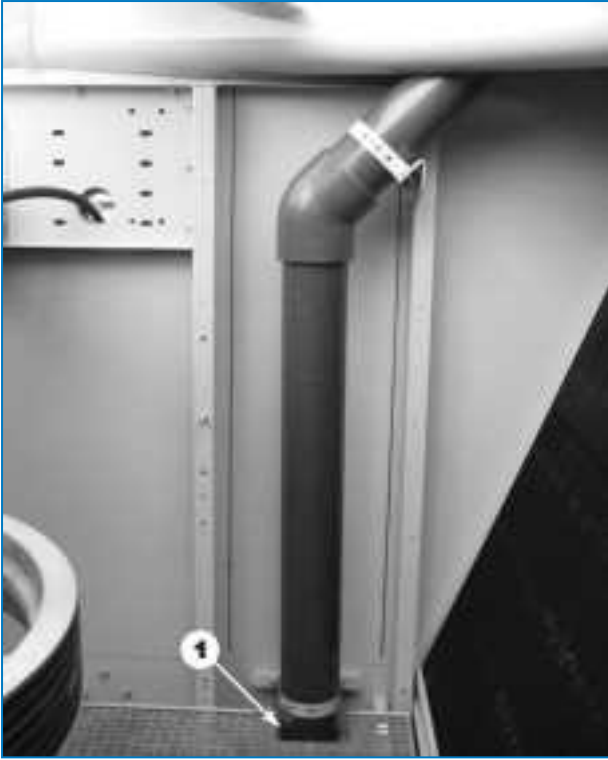
Intérieur de la section plenum tuyauterie de pompe
