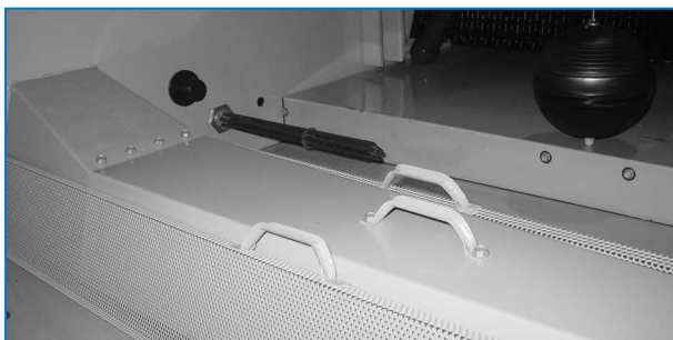
Bassin d'eau froide et tamis
