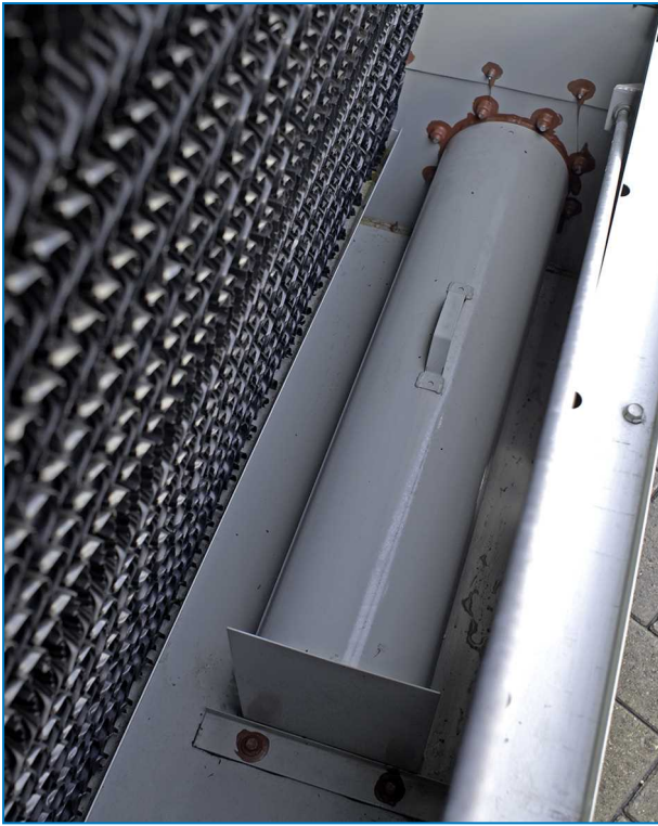
Bassin d'eau froide et tamis
