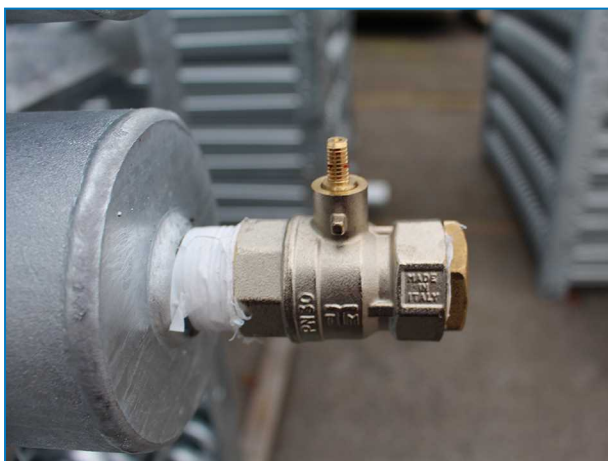
Bovenste batterijaansluiting met drukaflaatklep op condensoren.
